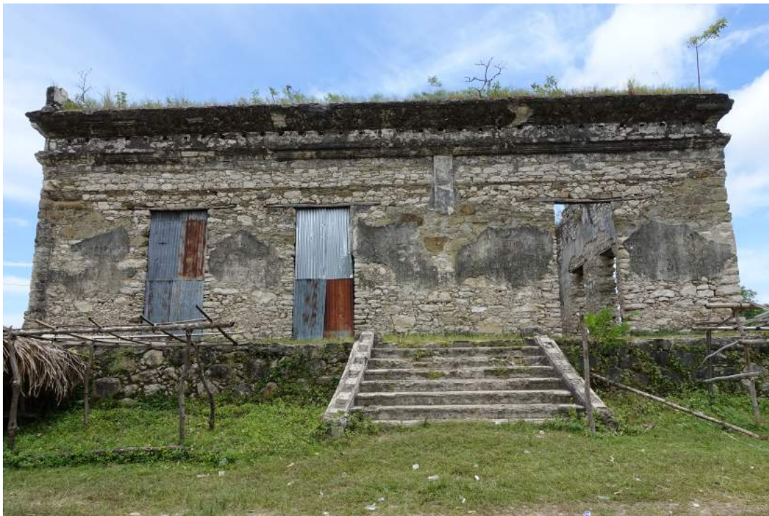
Foto 3 – Visível estado de degradação da Escola D. Carlos Filipe Ximenes Belo Autor: Fernando Carvalho
